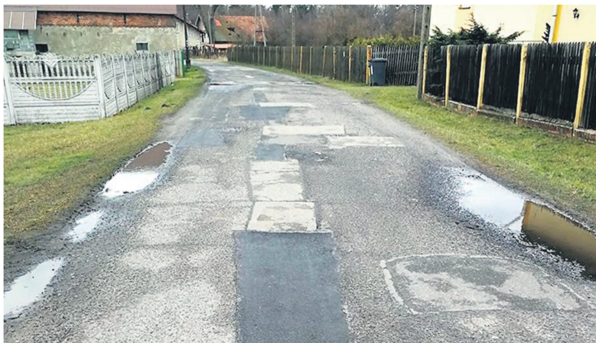
Zamoście – 70 mieszkańców wystąpiło do Zarządu Powiatu o wyremontowanie tej drogi. Zamiast remontu Zarząd Powiatu znalazł inne rozwiązanie – podarowanie drogi miastu.
